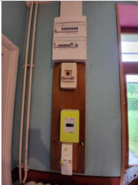
Date: 05/05/2022 Installation électrique
