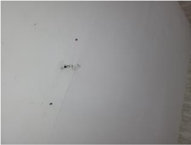
Date: 05/05/2022 Présence de douilles de chantier
